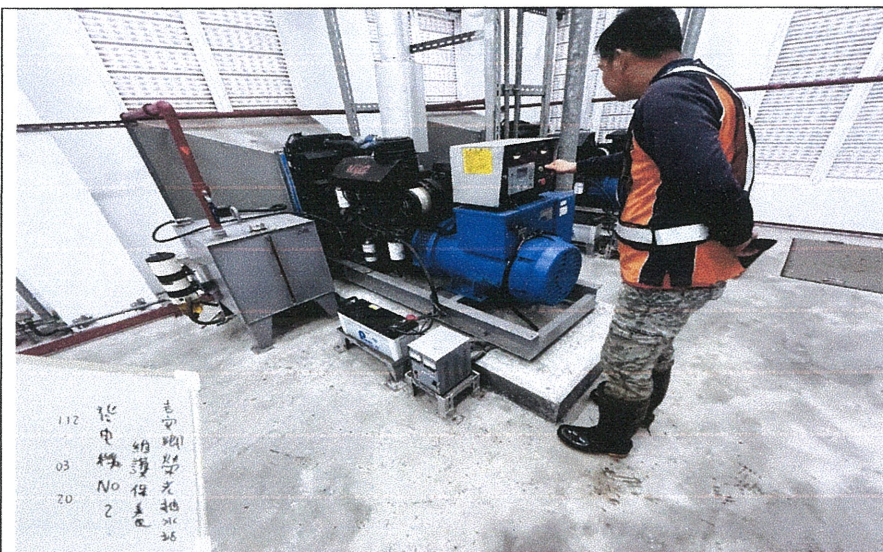
發電機○試車運轉
