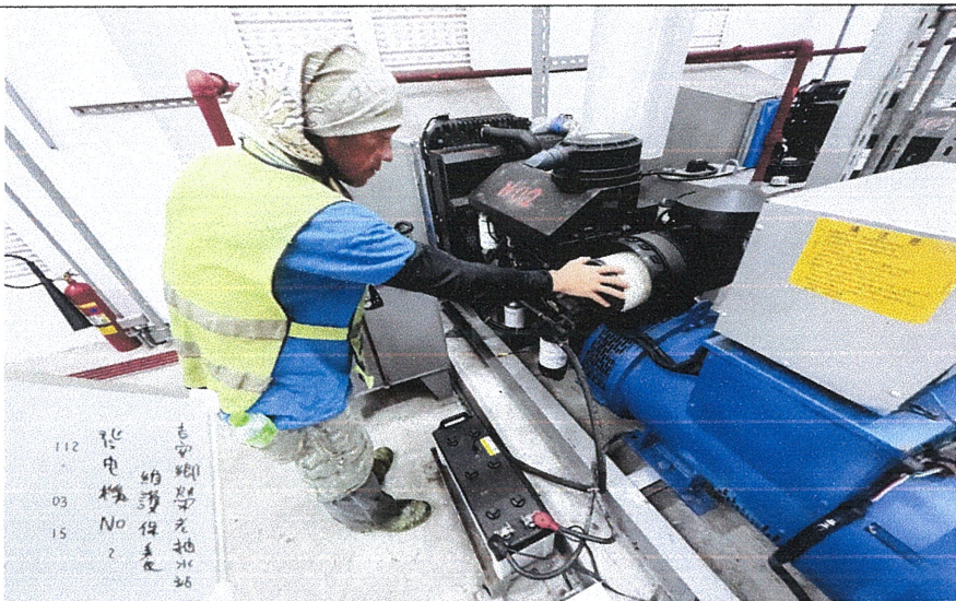
發電機維護保養
