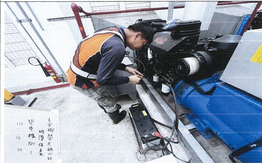
發電機○維護保養
