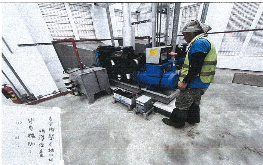
發電機試車運轉
