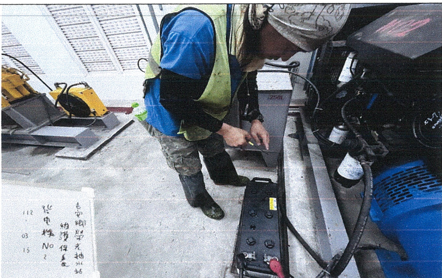
發電機維護保養
